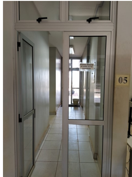
Foto 24 – Bloco I – Circulação para área administrativa - Portas a serem demolidas e construídas novas portas em vidro temperado e metálica.
