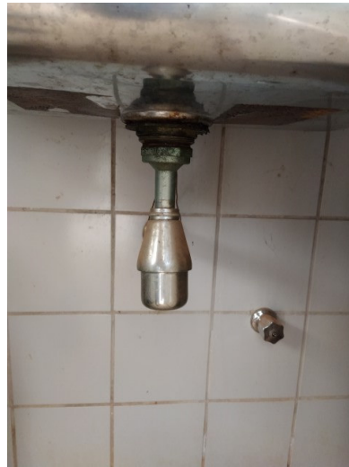
Foto 60 – Bloco II – Copa – Sifão e válvula da cuba da copa a serem substituídos. Sifão metálico, rígido e válvula americana, metálica.
