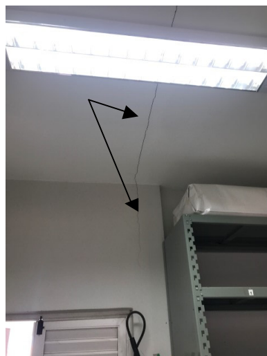
Foto 54 – Bloco I – Galpão de urnas – Trinca na laje e na parede do depósito a serem abertas, aplicado PU e fita telada de poliéster para posterior emassamento e pintura.
