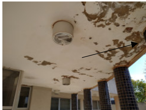
Foto 36 – Bloco I – Laje de forro da marquise circular – Remoção de reboco e recomposição, conforme indicação de planta de forro, após aplicação de cimento polimérico. Remoção de acabamento, novo emassamento e pintura acrílicos. Substituição de luminárias.
