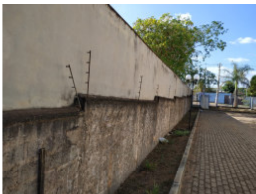
Foto 10 – Chapisco existente deverá ser removido (80cm abaixo do topo do muro), executado novo chapisco com aditivo impermeabilizante e executada pintura na cor cimento. O chapim existente deverá ser lavado com jato de água sob pressão e, se necessário, limpar com solução de hipoclorito de sódio.
