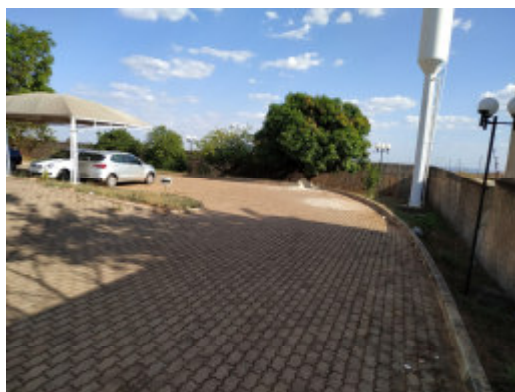
Foto 11 – Todo o muro lateral deverá receber o tratamento descrito na foto 10. O remanescente do muro lateral, assim como o muro de fundos deverá receber chapim pré-moldado de concreto. Muros e chapins deverão ser pintados na cor cimento.
