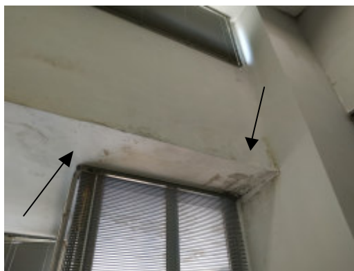
Foto 32 – Área de atendimento - Pontos de umidade a serem tratados. Pontos que apresentem manchas pretas, com reboco apodrecido, deverão ser recompostos com argamassa contendo aditivo impermeabilizante, após aplicação de cimento cristalizante na base, finalizando com emassamento e pintura acrílicos.
