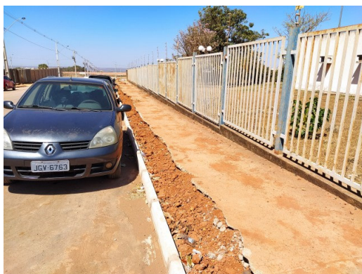
Foto 12 – Piso do passeio existente a ser demolido, executado desaterro, compactação e novo piso em concreto, e=7 cm. Ao lado da mureta do gradil, deverá ser executado arrimo conforme desnível resultante e detalhes de projeto específico.
