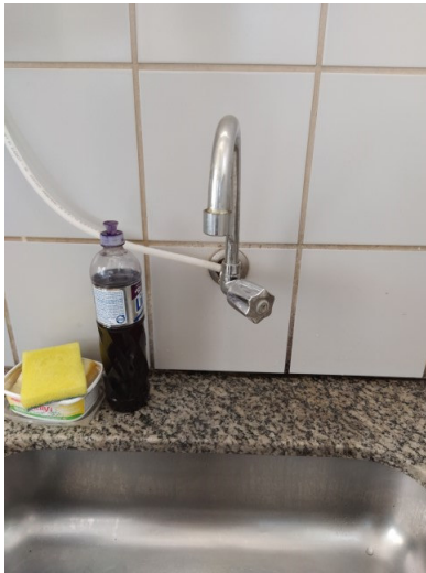
Foto 59 – Bloco II – Copa - Torneira da copa a ser substituída, por torneira de parede, com bica horizontal, marca Docol ou equivalente.
