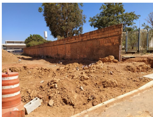
Foto 14 – Face externa do muro a receber chapisco e pintura na cor cimento. Todo o muro deverá receber chapim de concreto que deverá ser rejuntado e pintado.
