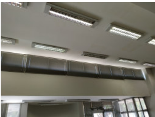
Foto 45 – Bloco I – Atendimento – Janela a ser vedada, com vão a ser fechado com blocos cerâmicos. Forro de gesso a ser complementado (Área junto à janela vedada – ver planta de forro – Prancha 10/11). Luminárias a serem mantidas. Grades a serem instaladas em portas e janelas.
