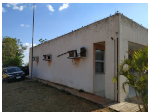
Foto 15 – Bloco I – Fachada lateral - Sistema SPDA e 2 caixilhos de ar condicionado a serem removidos. Os vãos dos caixilhos deverão ser vedados e revestidos. Instalação de chapim de concreto em todas as platibandas.
