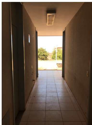
Foto 28 – Bloco II – Circulação - Piso cerâmico a ser demolido e construído piso em granitina, juntamente com rodapé, na circulação central. Portas a serem demolidas, fechados os vãos das bandeiras, executado revestimento na face interna com placas cerâmicas de 20x20cm retiradas do banheiro de uso público.
