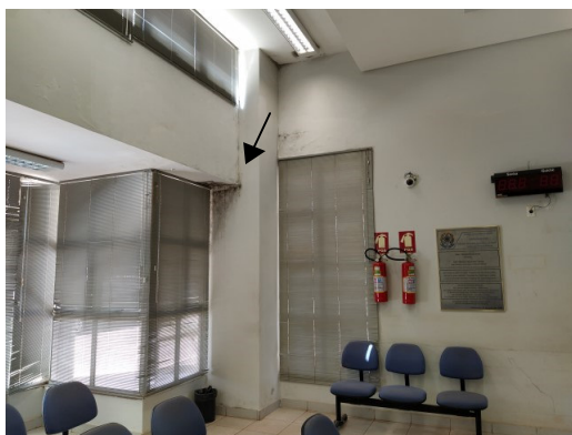
Foto 31 – Área de atendimento - Janela a ser vedada, grades a serem instaladas no requadro das esquadrias, tratamento de pontos de umidade com remoção e recomposição do reboco (argamassa contendo aditivo impermeabilizante) sobre cimento cristalizante, e posterior emassamento e pintura acrílicos.
