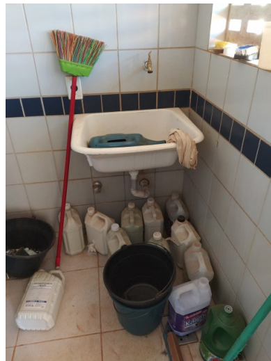
Foto 58 – Bloco II – Área de serviço – Piso a ser demolido e executado novo piso em porcelanato. Revestimento de parede a ser mantido. Tanque e torneira a serem substituídos. Cobogós a serem pintados na cor branco gelo.
