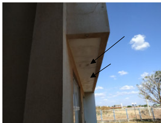
Foto 38 – Bloco I – Marquises laterais (projeção platibandas da fachada posterior) - Áreas com manchas de umidade e bolor a serem removidas, superfície lixada, emassada e pintada com massa e tinta acrílicas.
