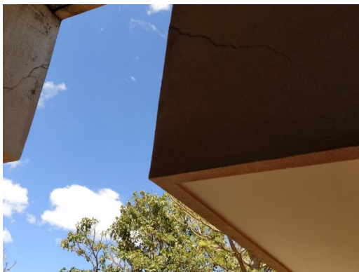
Foto 41 – Bloco I e II – Trincas nas platibandas a 45° deverão ser tratadas por meio de grampeamento, reconstituído reboco e acabamento em textura acrílica.
