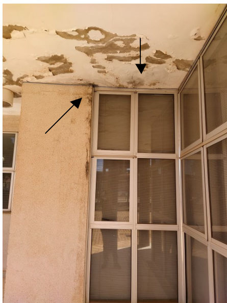
Foto 33 – Marquise circular - pontos de umidade a serem tratados. Pontos que apresentem manchas pretas, onde o reboco estiver apodrecido, deverão ser recompostos com argamassa contendo aditivo impermeabilizante, após aplicação de cimento cristalizante na base, finalizando com emassamento e pintura acrílicos.
