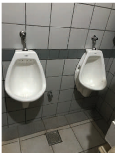
Foto 44 – Piso e revestimentos a serem demolidos e reconstruídos; mictórios a serem demolidos e reinstalados novas peças
