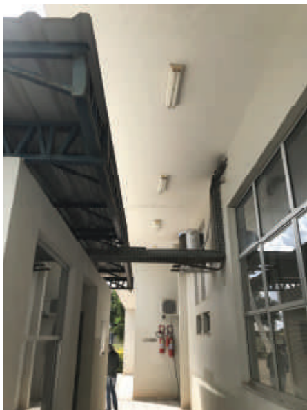
Foto 38 – Circulação entre blocos I e II – Piso a ser demolido e reconstruído; estrutura metálica da cobertura do Bloco II – a ser lavada, lixada, aplicado fundo neutralizador de oxidação e pintura com esmalte sintético, na cor azul del rey
