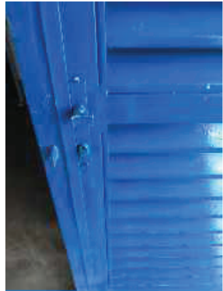
Foto 53- Portões do depósito de urnas e arquivo no bloco III – Maçanetas a serem substituídas
