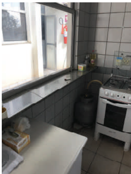
Foto 42 - Copa Bloco II – Piso e revestimento a serem demolidos e reconstruídos; peitoril/ bancada a ser demolido e reconstruído novo peitoril e instalada nova janela
