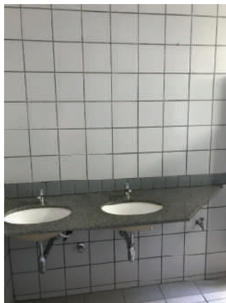
Foto 30 - Banheiros de uso público feminino Bloco I – Piso, revestimento, bancadas a serem demolidos e reconstruídos; torneiras a serem removidas e instaladas nos sanitários de servidores, espelho a ser instalado
