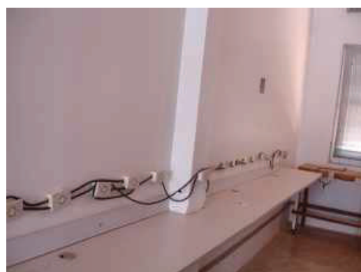
Foto 56 – Instalações elétricas a serem removidas e executada nova instalação conforme projeto elétrico
