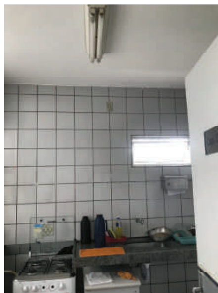
Foto 43 – Piso e revestimentos a serem demolidos e reconstruídos; bancada a ser mantida
