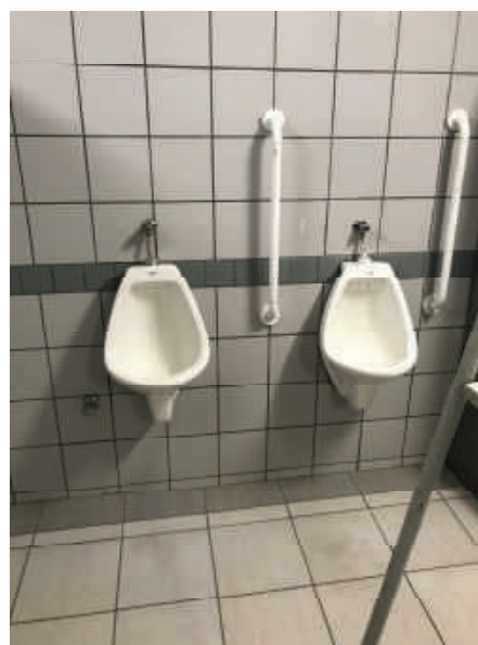
Foto 34 – Banheiros de uso público masculino a serem transformados em feminino após reforma - Mictórios a serem removidos e instalações hidrossanitárias isoladas. Barras de apoio ao lado dos mictórios a serem reutilizadas nos boxes acessíveis, instaladas na vertical
