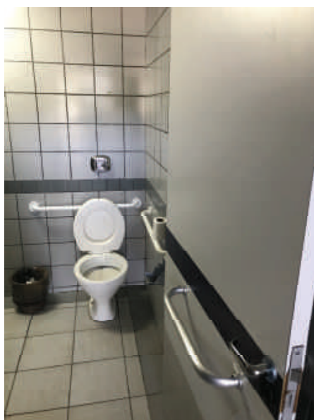
Foto 33 – Piso, revestimentos, louças e portas a serem demolidos e reconstruídos; Barras de apoio horizontais a serem reutilizadas – Ver detalhes nas Pranchas 09 e 10/12
