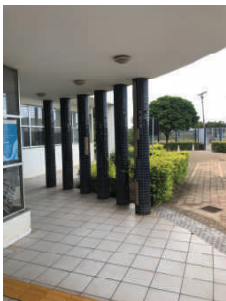
Foto 22 - Pilares abaixo da marquise circular – revestimento em pastilhas a ser complementado com peças removidas da fachada lateral do bloco I – parte central. Remoção do revestimento existente abaixo da marquise e aplicação de faixa de 30 cm de massa acrílica e pintura acrílica na cor branco neve
