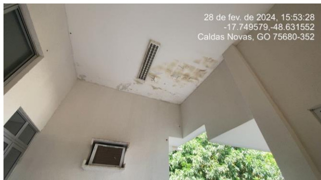
Foto 79: Infiltração no teto e fazer fechamento do shaft do ar condicionado
