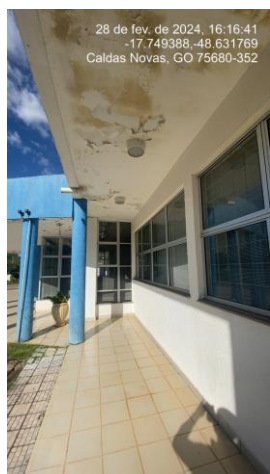
Foto 15: Teto com infiltração, lado esquerdo da marquise.
