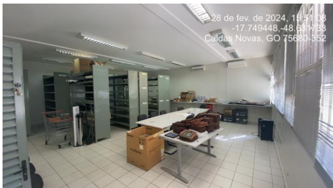
Foto 51: Infiltrações no teto.
