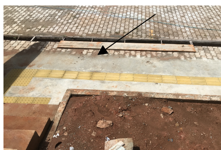
Figura 14 - Tipo de finalização entre concreto e bloco intertravado não será permitida
