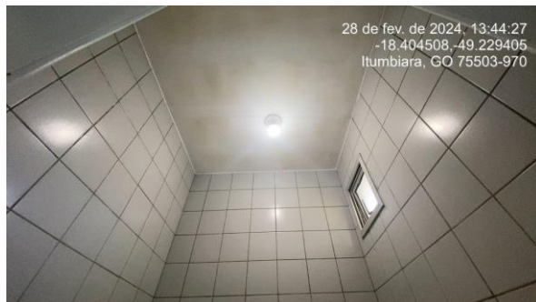
Foto 80: Teto com infiltrações.
