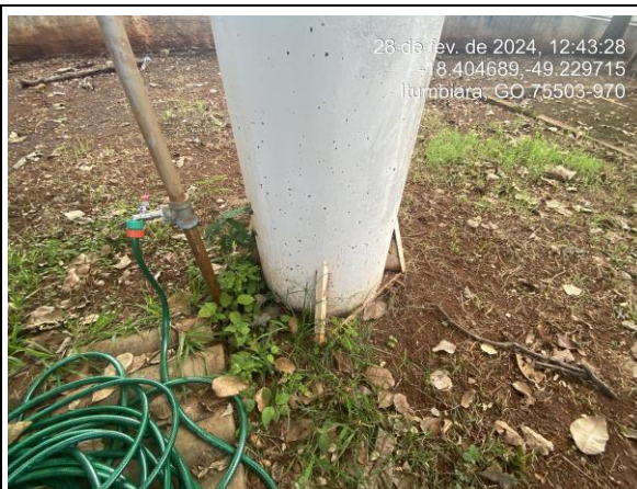
Foto 22: Trocar conexões, com vazamento.
