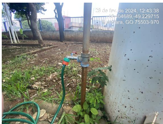
Foto 23: Trocar conexões, com vazamento.
