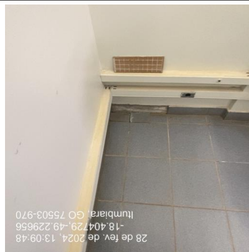
Foto 64: Remover eletrocalha da parede, revestimento solto do rodapé.
