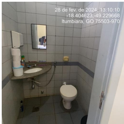
Foto 65: Substituir revestimentos piso, parede, louças e metais.
