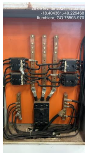
Foto 109: Quadro sem dispositivo de proteção.
