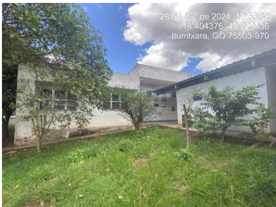
Foto 36: Fazer poda das árvores, para as raízes não comprometerem a edificação futuramente.
