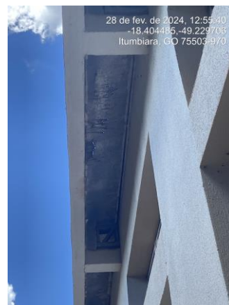
Foto 37: Calha do Deposito com vários furos, deve ser trocada.
