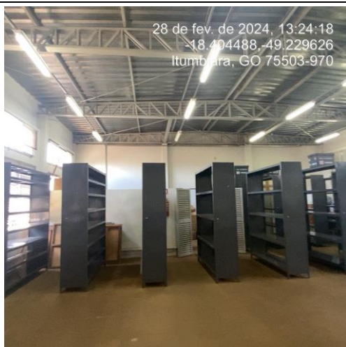
Foto 118: Substituir calha furada.
