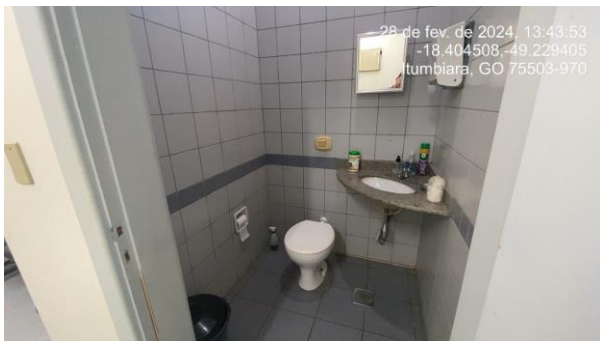
Foto 81: Porta esta emperrada, colocar espelho sobre o lavatório.
