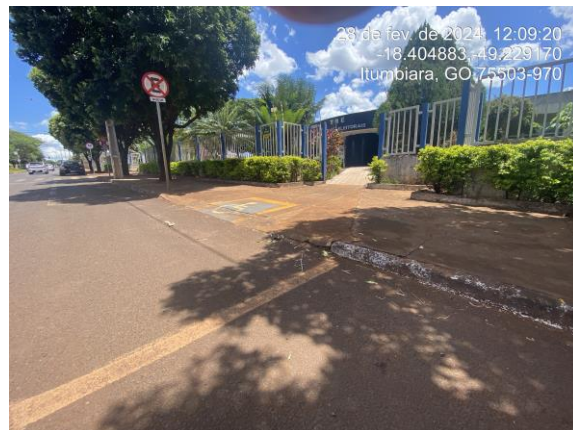
Foto 06: Corrigir rampa de acessibilidade na calçada na Av. João Paulo I
