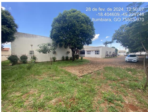
Foto 19: Fazer poda de Árvore próximo ao bloco de depósito, (Para raiz da afetar a fundação da edificação).
