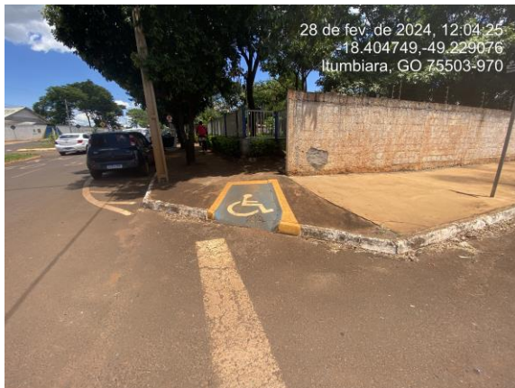
Foto 05: Corrigir rampa de acessibilidade na calçada da rua Gercino Flausino Fidelis.
