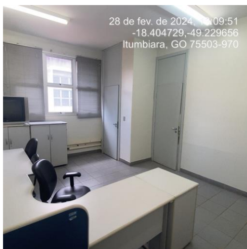
Foto 63: Piso se encontra oco, trocar piso.
