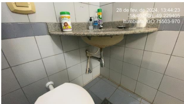
Foto 79: Substituir revestimentos piso, parede, louças e metais.
