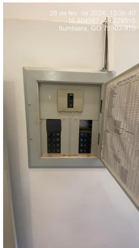
Foto 87: Substituir disjuntores, adicionar novo IDR e aproveitar DPS.
