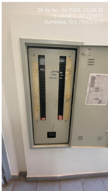
Foto 86: Substituir disjuntores, adicionar novo IDR e aproveitar DPS.
