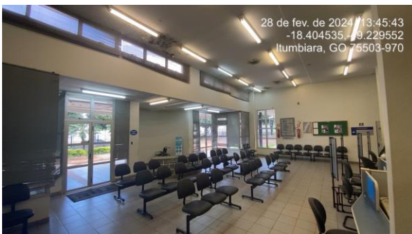
Foto 40: Recepção/atendimento – Guichês a remover, tomadas de piso a isolar e recompor piso no local das tomadas.
