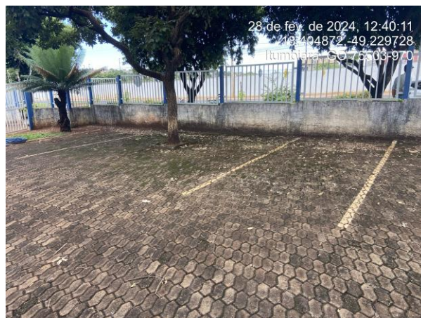
Foto 20: Refazer a sinalização horizontal para demarcação de vagas. Lavar muro com jato de alta pressão, para posteriormente realizar pintura.
