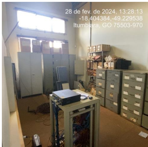
Foto 108: Instalar placa de sinalização de risco de choque
