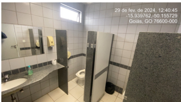
Foto 87: trocar piso, parede e bacias sanitária.
