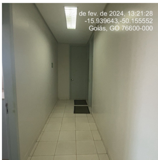
Foto 74: Sinalização de circulação (incêndio, saídas de emergência) a serem removidas e reinstaladas após pintura de paredes.
