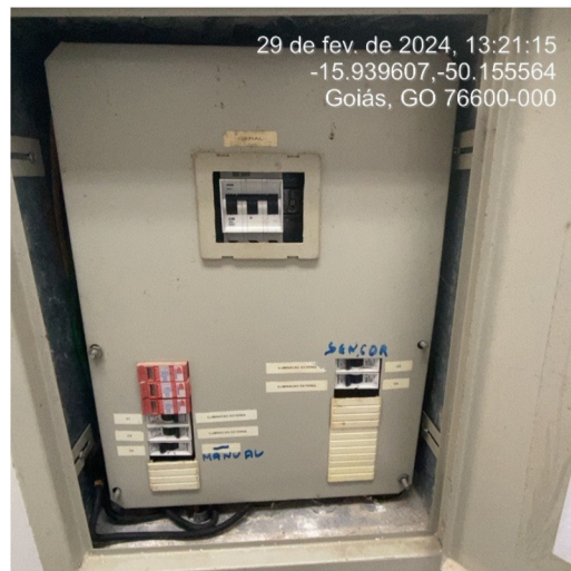
Foto 73: Falta a instalação do IDR
