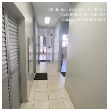
Foto 75: Sinalização de circulação (incêndio, saídas de emergência) a serem removidas e reinstaladas após pintura de paredes.
