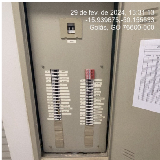
Foto 72: Falta a instalação do IDR
