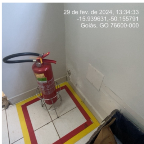
Foto 57: Infiltração por capilaridade.
