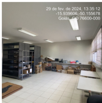
Foto 58: Infiltrações no teto.
