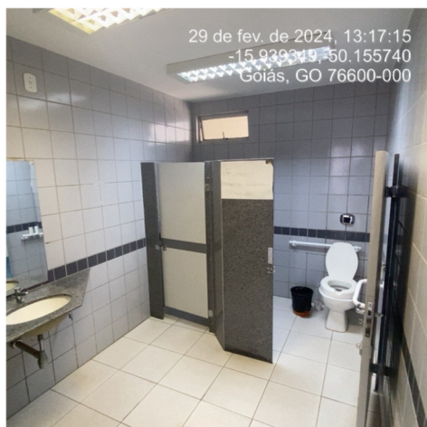
Foto 68: Adequar novo layout para acessibilidade. E reaproveitar portas.
