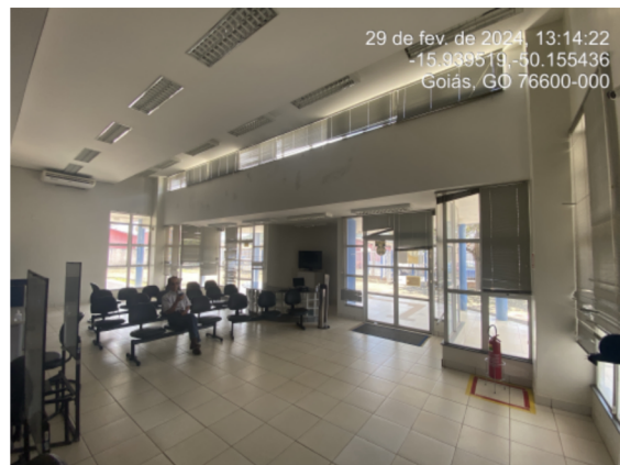
Foto 50: Infiltrações no teto.
