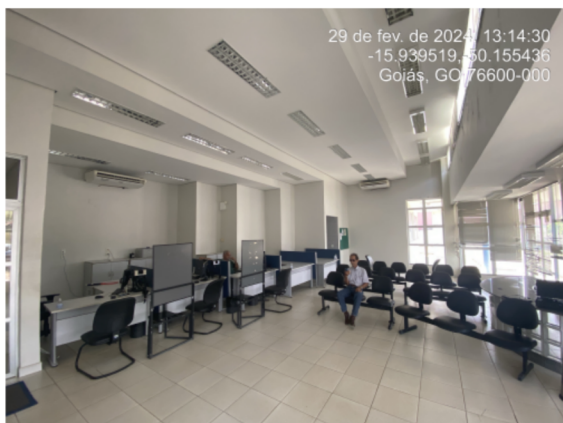
Foto 49: Piso oco e soltando.
