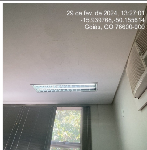
Foto 44: Teto com Infiltrações.
