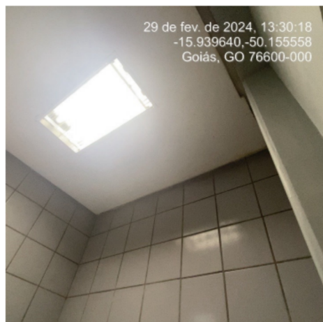
Foto 37: Infiltrações no teto.
