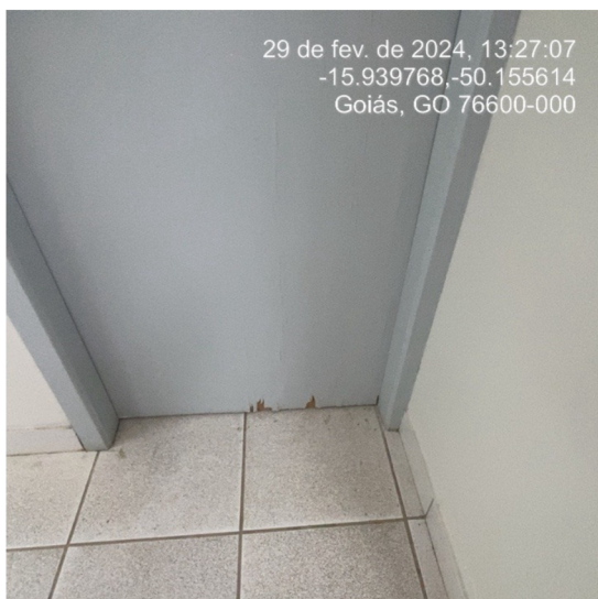
Foto 41: Porta danifica na base.
