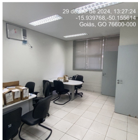
Foto 36: Portas danificas, empenadas e estouradas embaixo.
