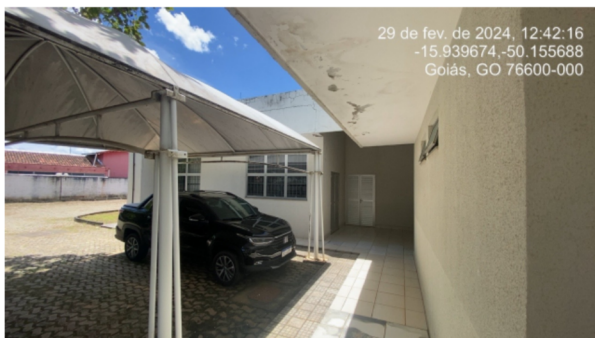
Foto 19: Apresenta infiltrações no teto.
