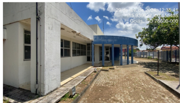
Foto 20: Apresenta infiltrações no teto, reparar trincas.
