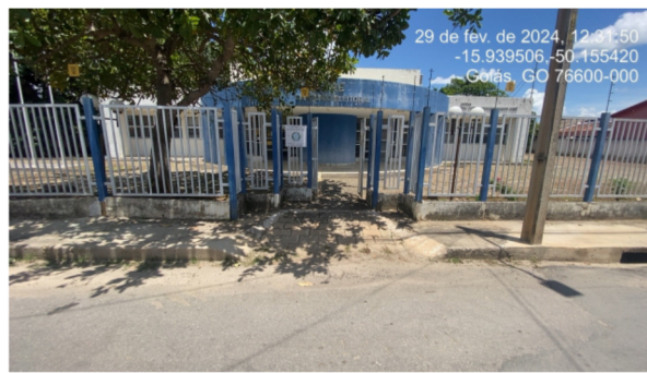
Foto 02: Adequar rampa de acessibilidade.
