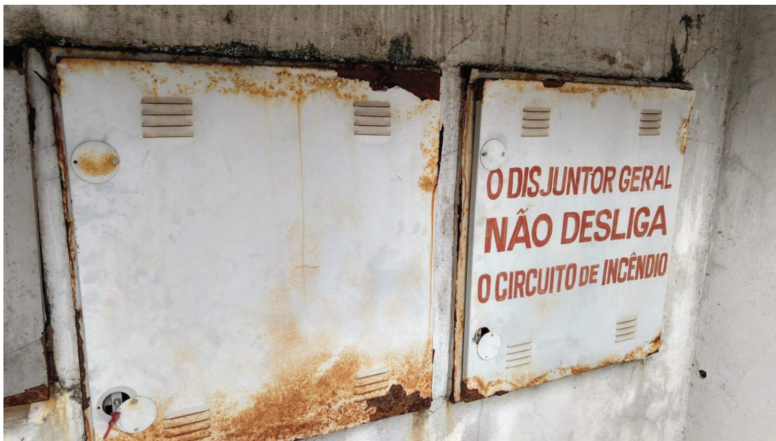
Foto 3 – Caixa de TC's e caixa de proteção geral
