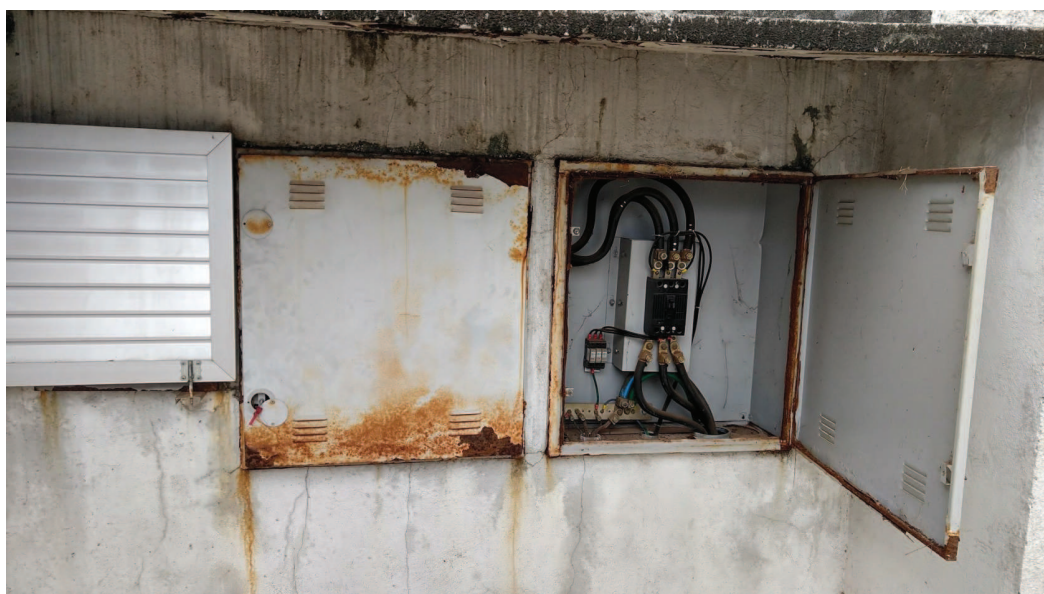
Foto 2 – Veneziana de proteção da caixa do medidor, caixa de TC's e Caixa de proteção geral
